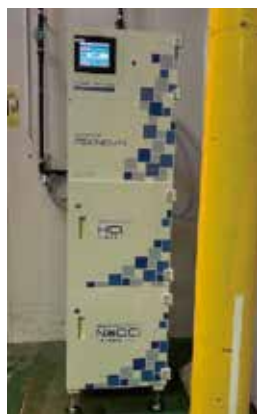
扉付架台（薬液縦置）
